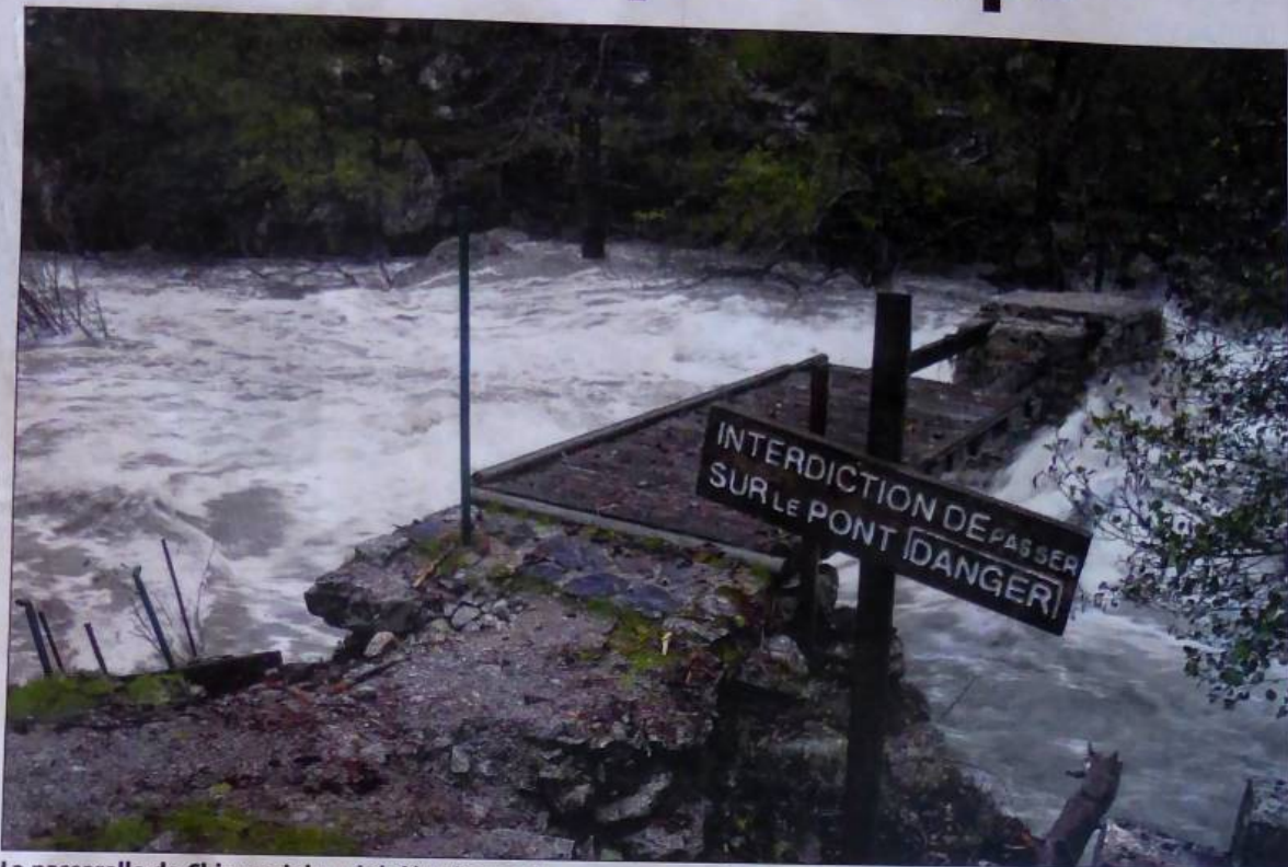
La passerelle de Chjarasgiolu a été détruite par la crue en novembre 2011.
